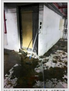
4名工人在地下室施工，疑通風不良，未配戴防護器具，吸入甲苯、二甲苯導致中毒昏迷。(記者鄭淑萍攝)
