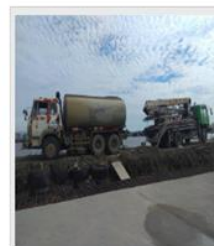
台中港5A碼頭工程，因水車無預警側車，造成張姓工人被夾傷送醫，至今尚未脫離險境。(記者歐素美拍攝)
