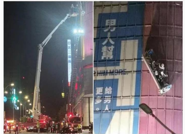
3名工人昨晚南京微風百貨外牆施工時，吊籠傾斜，受困空中。翻攝臉書「爆料公社」
