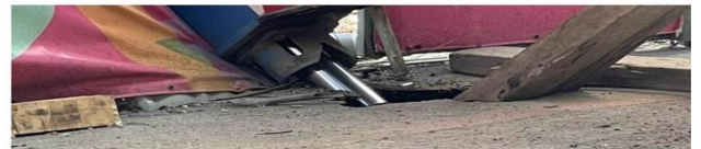
初步調查，吊車外伸撐座置於水溝上，於吊掛鋼筋作業時，水溝蓋破裂導致吊車翻倒。(翻攝照片/高雄訊傳真)
