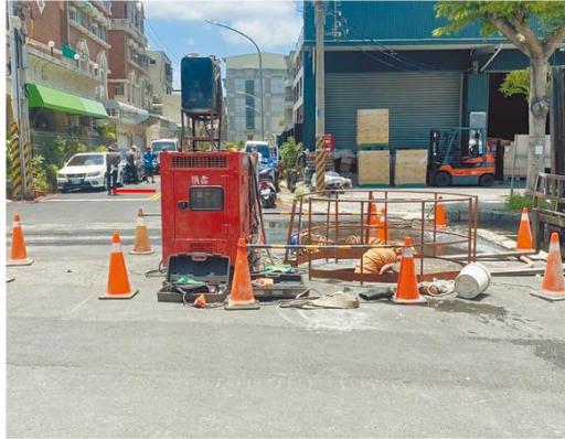
49歲王姓工人在仁武區八德中路上水道作業時，疑吸入沼氣中毒，導致全身癱軟摔下水道，讓另一名工友見狀趕去救援的王男，卻不慎受傷，警消獲報後到場將2人拉出，所幸均意識清醒，已送往醫院治療。(高雄消防局提供/林強聖攝)
