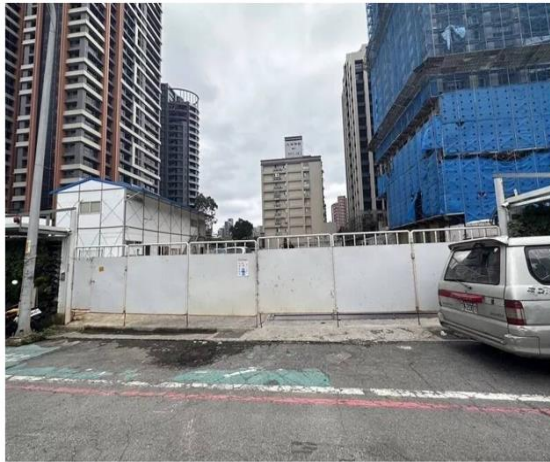
新北市林口一處工地傳出一死工安意外，勞檢處今天派員調查，勒令停工，將依職安法函送違失包商現場幹部，提供家屬最大協助。(記者吳仁捷攝)
