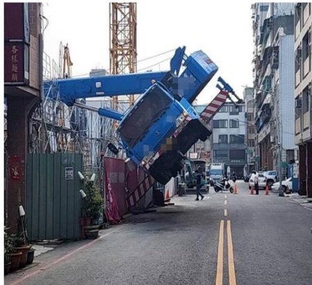
1輛吊車因吊車外伸撐座置於軟弱地盤，致吊車翻倒。(翻攝照片/高雄訊傳真)
