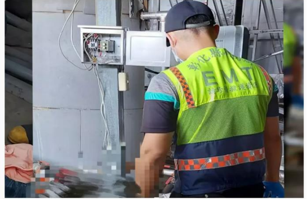
54歲林姓工人，今天下午到彰化市某汽車旅館頂樓檢修熱水爐時，遭220伏特電壓電擊，當場死亡。圖／民眾提供
