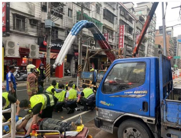
新北市板橋區長江路二段234號前一處工地，今天下午3時許發生施工意外，該工地疑因路燈倒塌造成漏電，3名工人受傷。記者李易昌 / 翻攝
