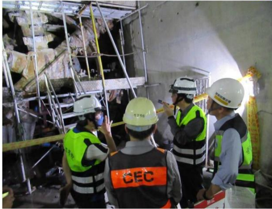
台北市勞動檢查處針對萬大線工地進行勞檢，發現工人未投保保等多項缺失，共開罰15萬元。(勞檢處提供)
